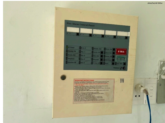
21. Fire control box.jpg
