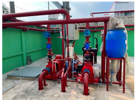
20. Firewater pump system.jpg
