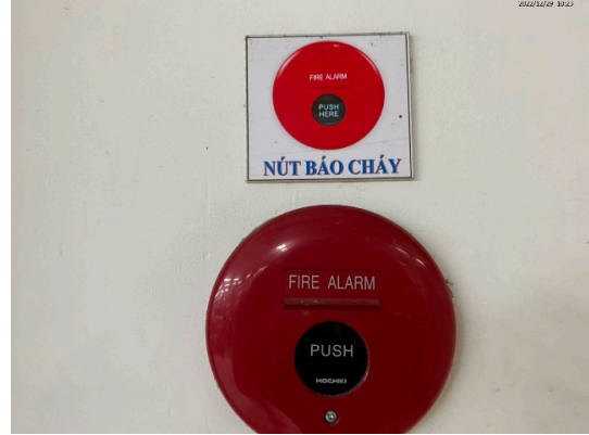
13. Fire alarm button.jpg
